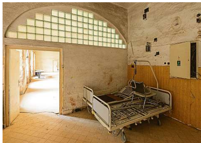
Opravy budou pokračovat Rekonstrukce dalších prostor a výměna střechy by měly stát 160 milionů korun.
